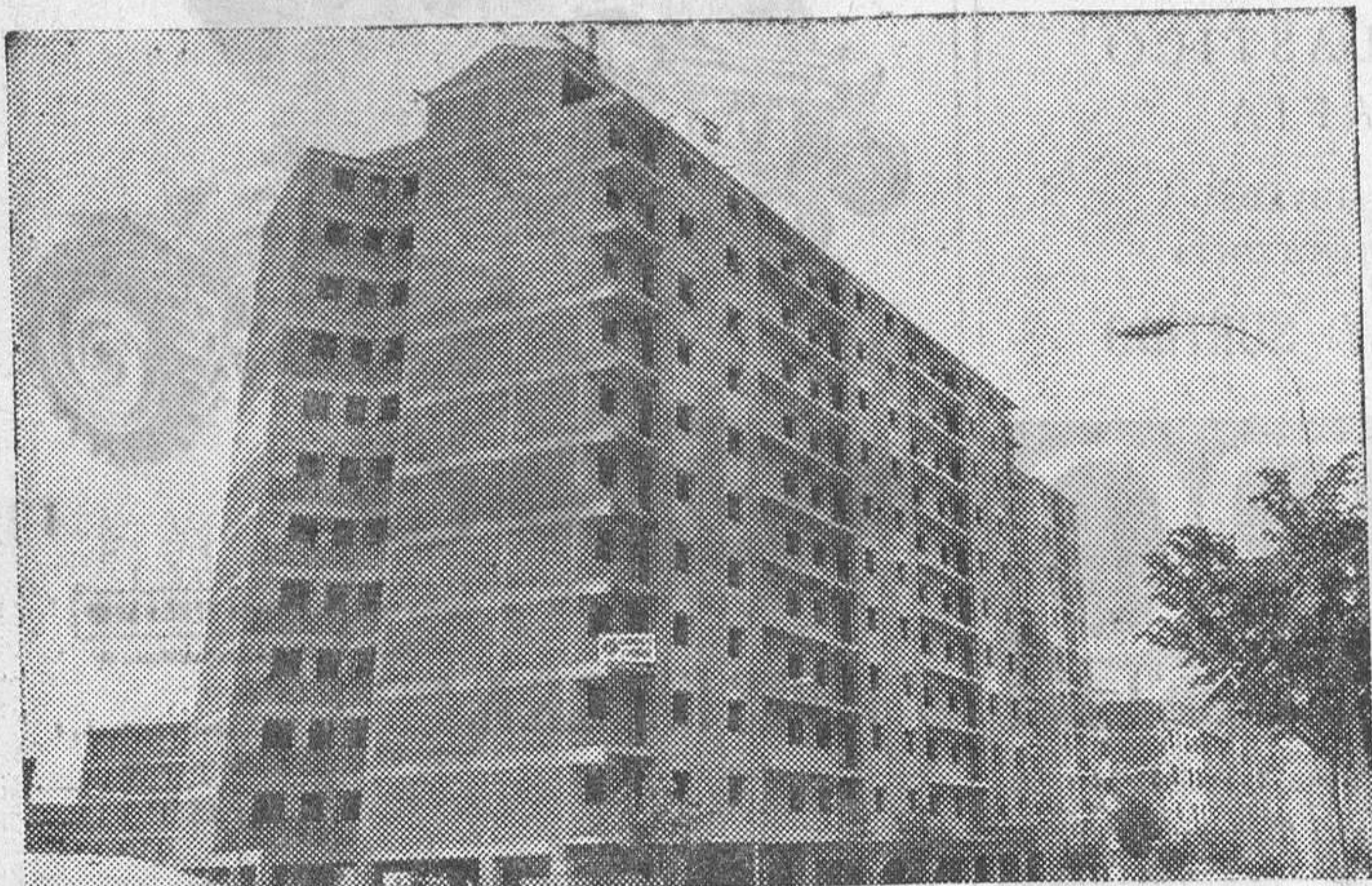
GRUPO "EL CID", INSTALADO POR COINSA
