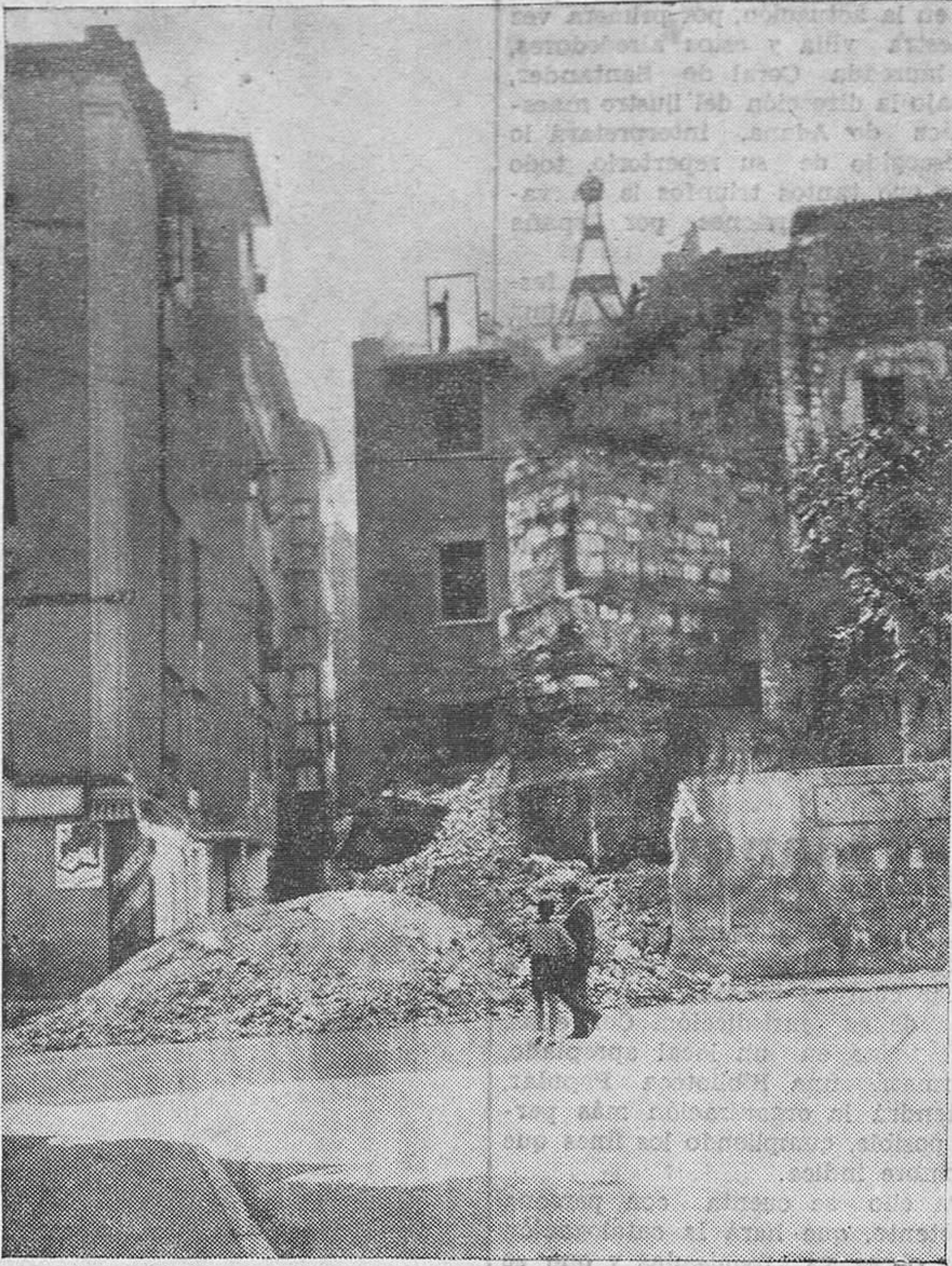
LAS OBRAS DE TRANSFORMACION DE SANTANDER. — Ya se ha cortado el trozo de muro que permitirá la construcción de una calle que una a la de Cádiz con la avenida de Galán y García Hernández. (Foto Samot.)
