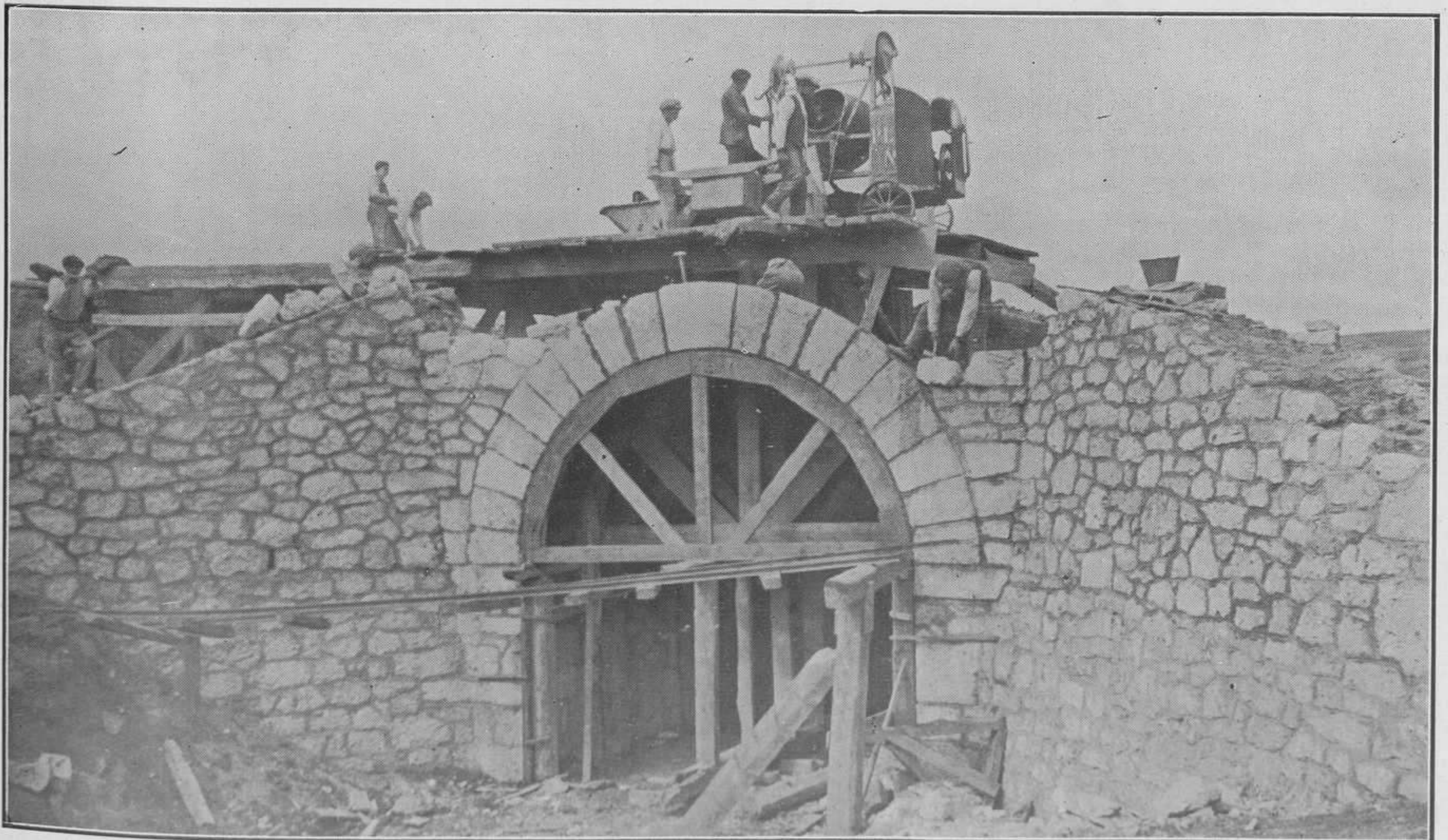
MODUBAR.—El primero de los túneles que se ha construido en la nueva línea del ferrocarril Santander-Mediterráneo.
