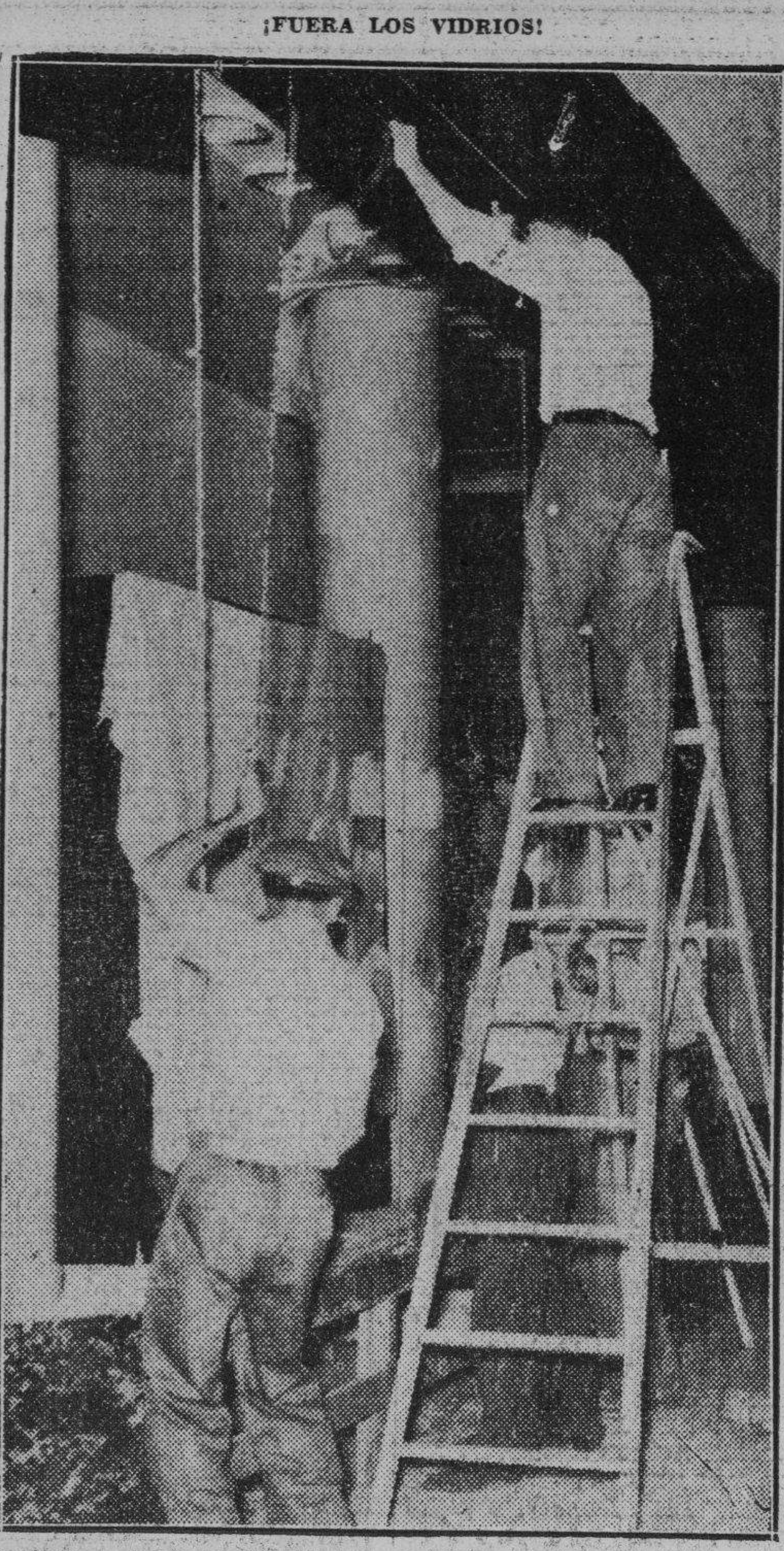
Recogemos en esta foto el momento en que varios obreros están sacando los inmensos vidrios que forman las vidrieras de «Los Precios Fijos»...
