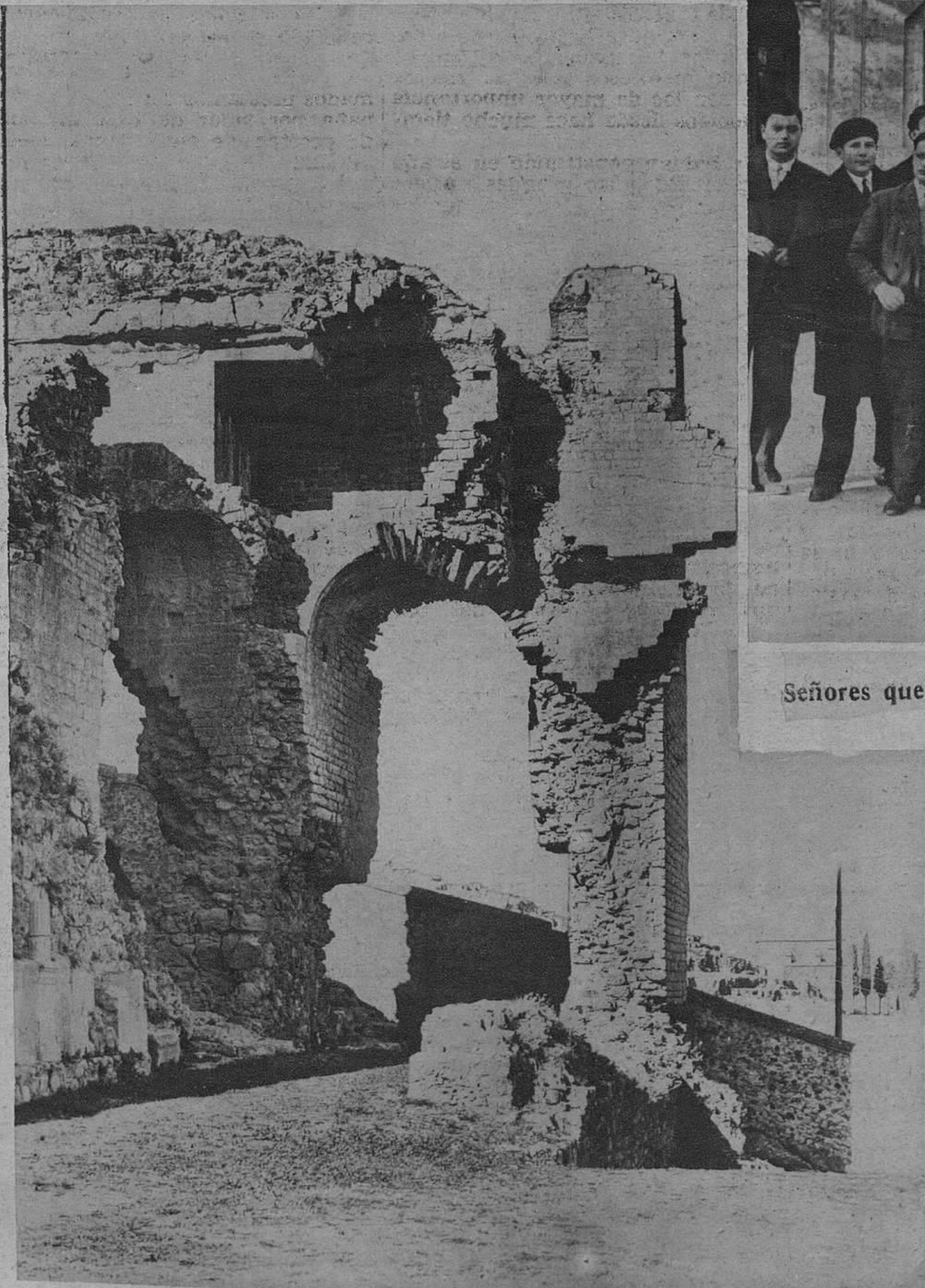
El pórtico del Teatro Romano de Sagunto, que amenaza ruina, y para cuya consolidación se ha consignado recientemente un crédito.
