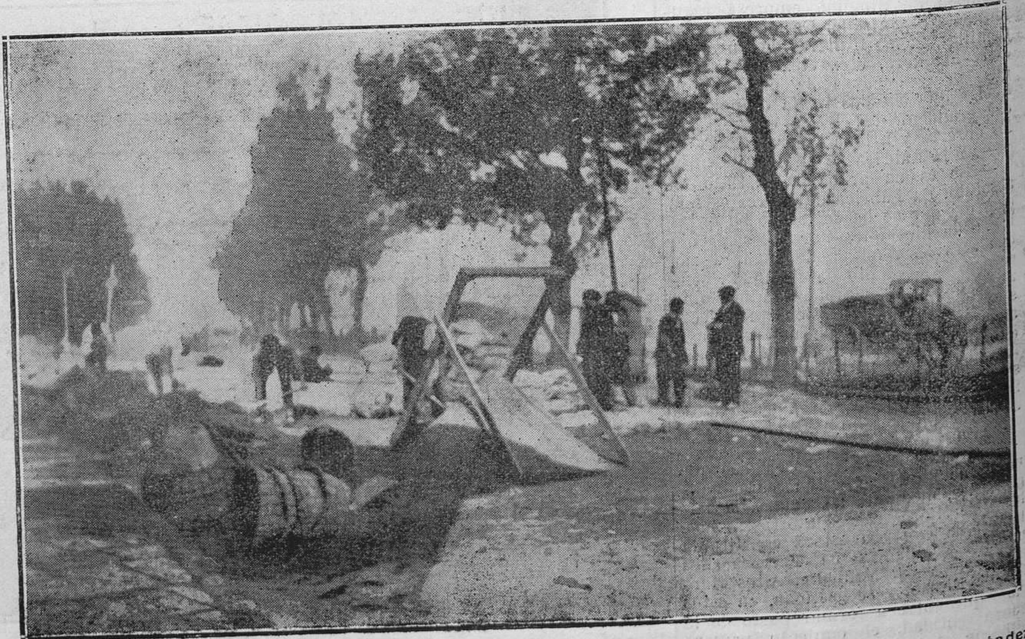
AVILES: MEJORAS LOCALES.—Obras de adoquinado que se efectúan en la calle del Muelle.
