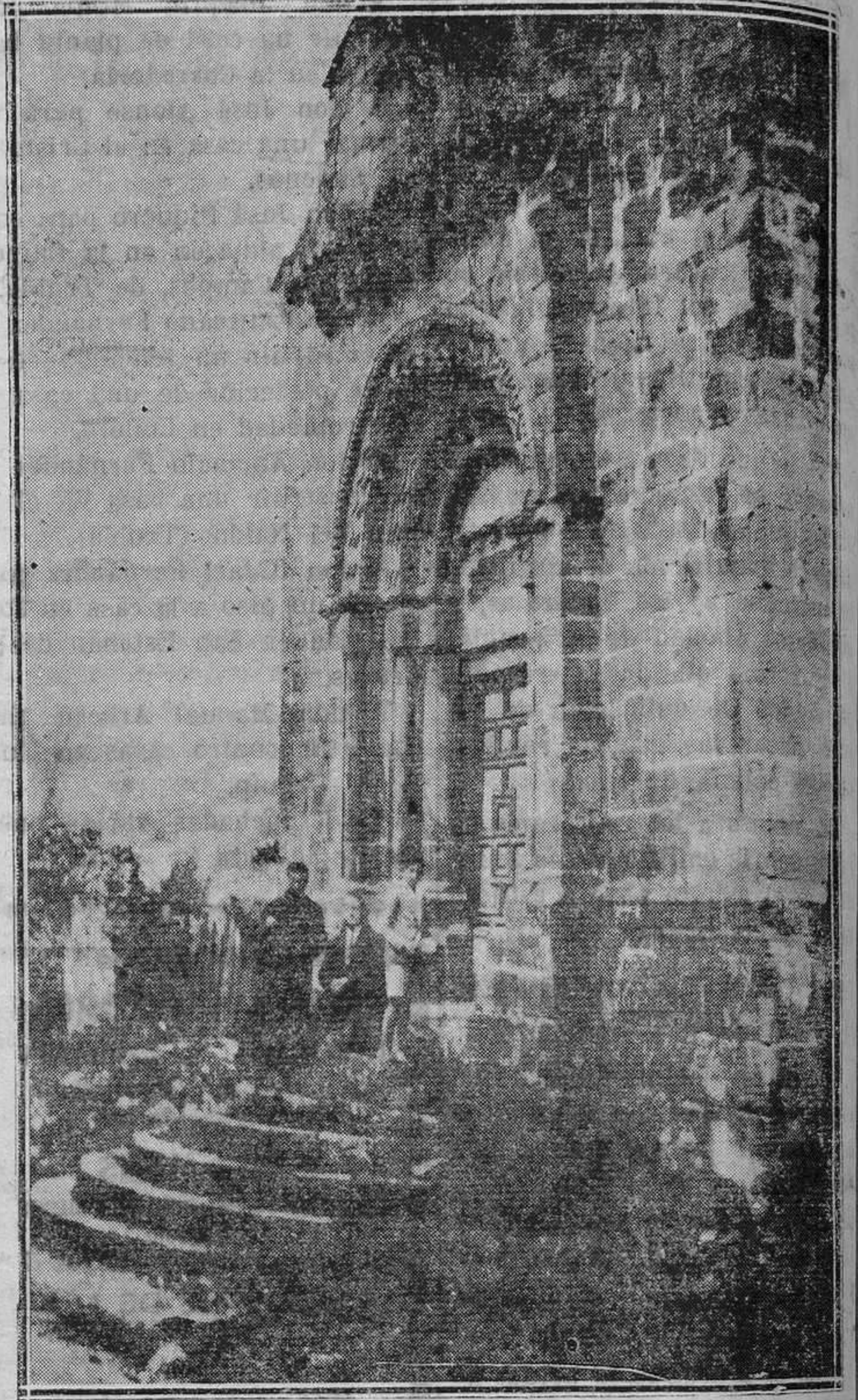
Hermosa fachada de la iglesia de San Pedro de Arrojo, (Quirós), obra románica del siglo XII, cuya restauración y consolidación se solicita. (Foto MENA)
