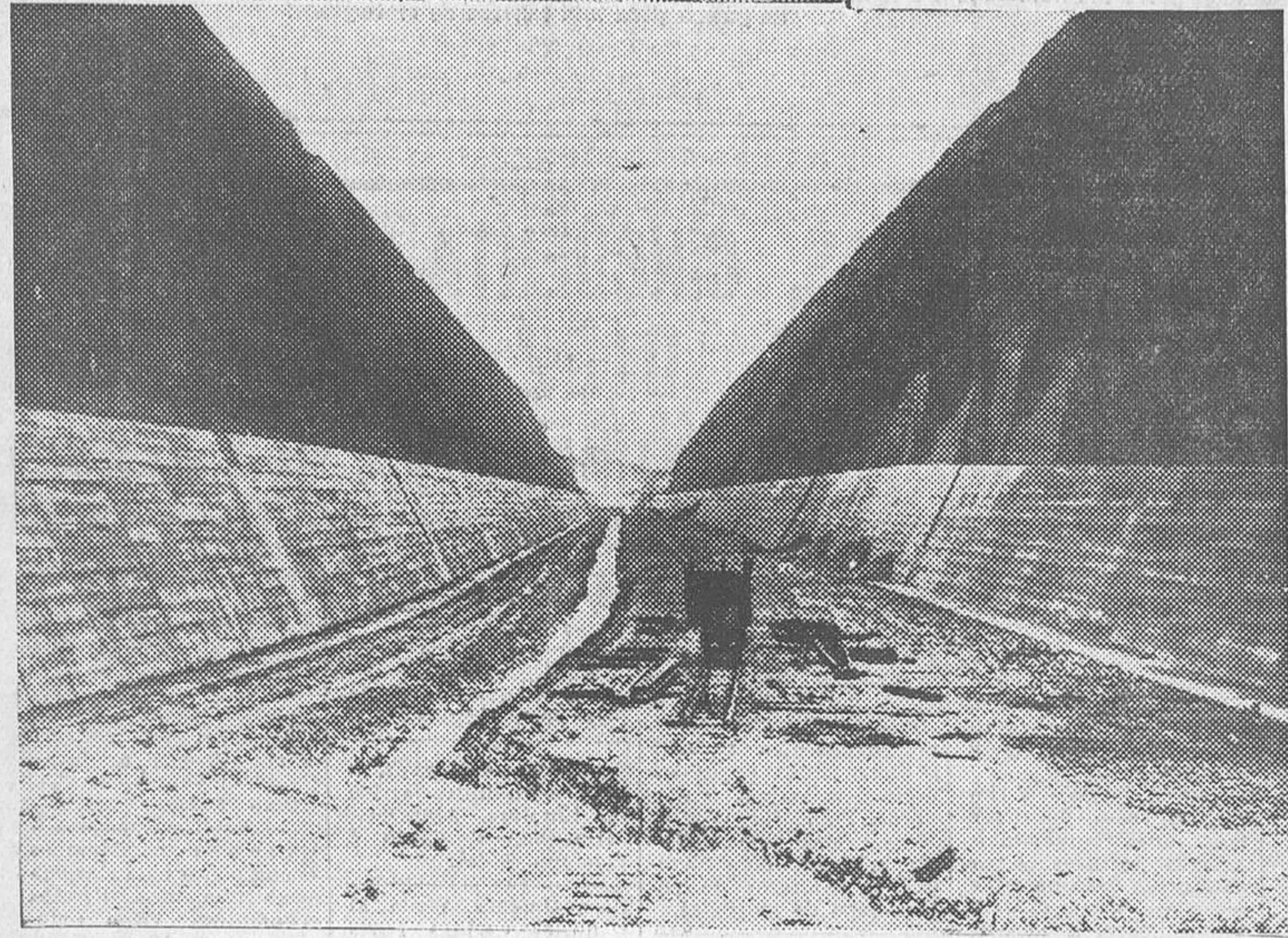
El rey de los belgas visita el canal Albert. Vista general del estado actual de las obras del canal (Fot. Ortiz-Keystone.)
