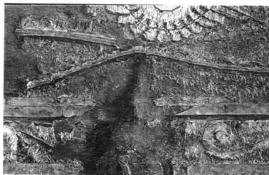
8.- Parte inferior central: grieta
