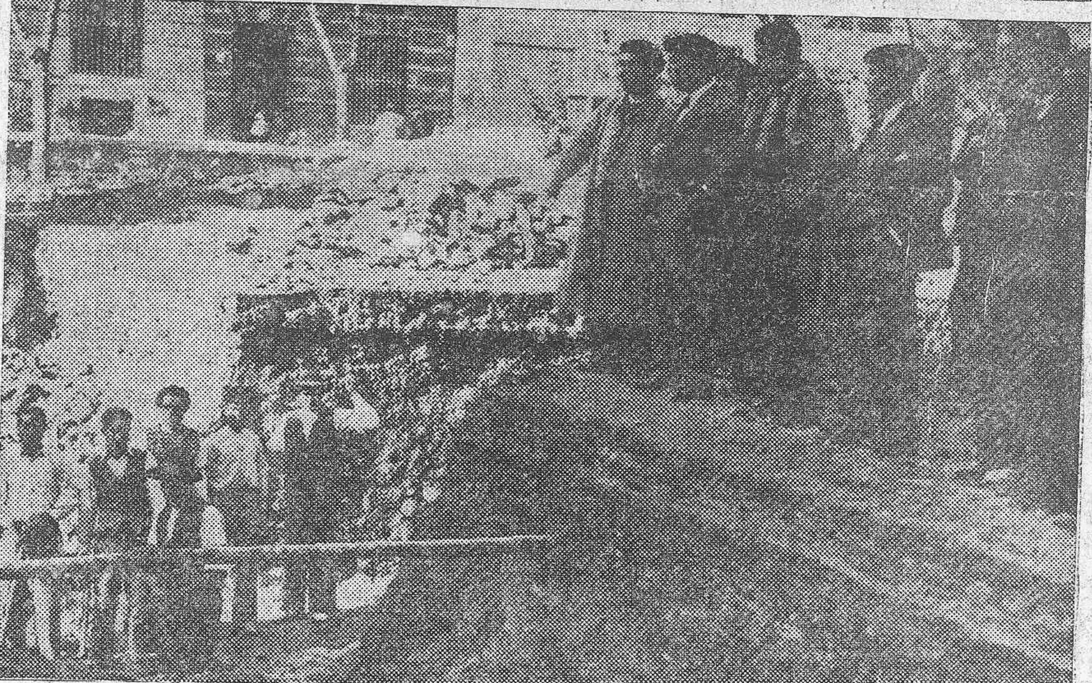
El ministro de Obras Públicas, acompañado del Gobernador de Murcia, camarada Cabo Giorla; del alcalde, camarada Piñuela, y del diputado socialista camarada Melchor Guerrero, en la visita que efectuó ayer a las obras de los refugios subterráneos
