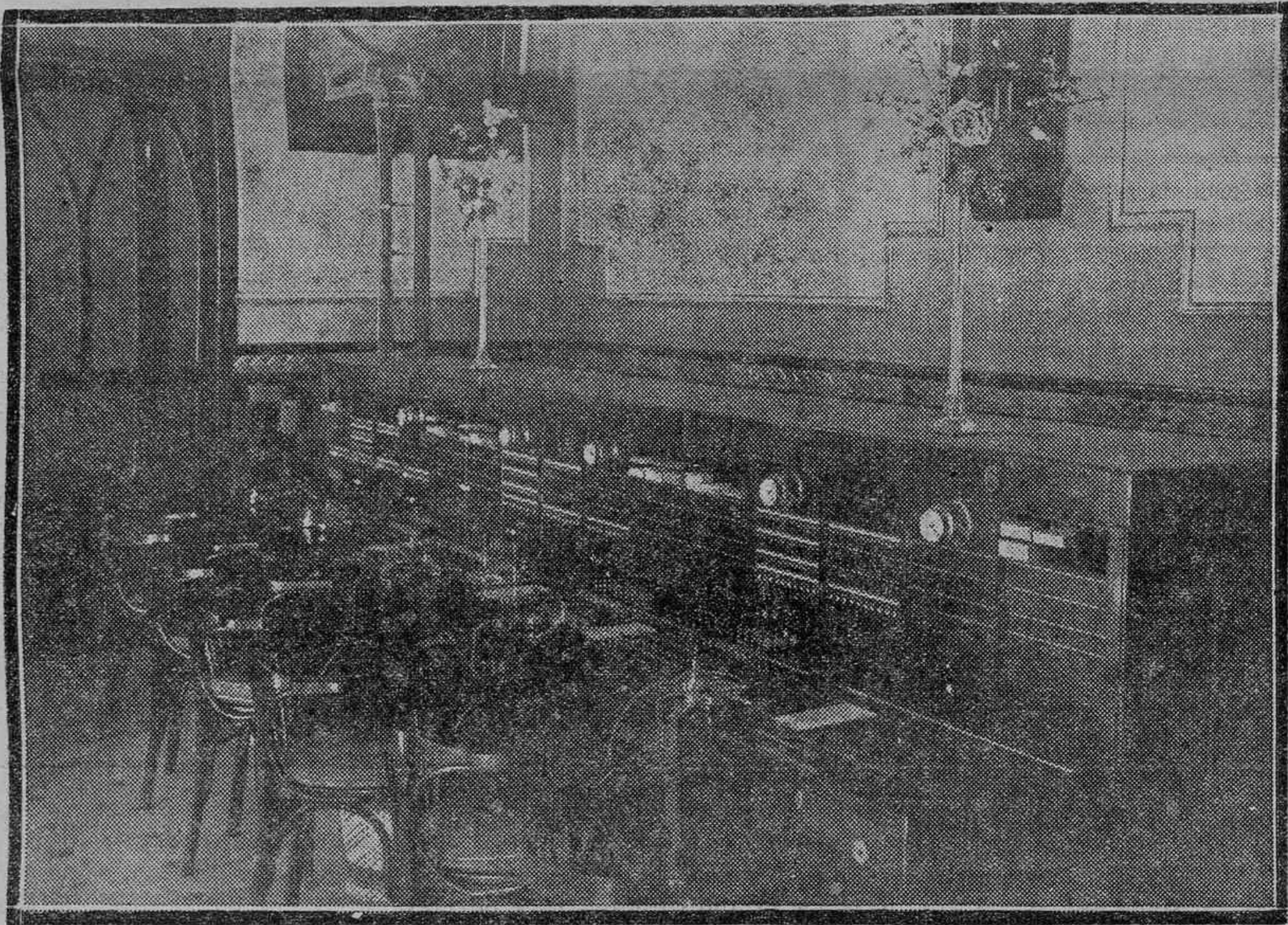
Cuadro conmutador múltiple luminoso interurbano, en la central de esta capital
