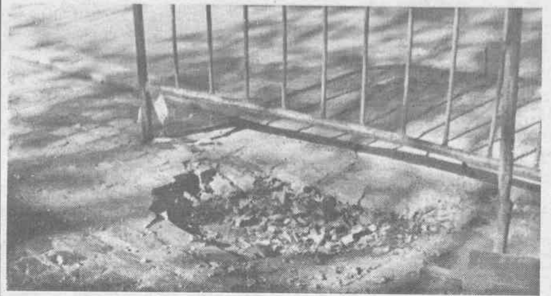
A pesar de la reciente remodelación de la carretera de Andalucía se observan deterioros en esta avenida.
