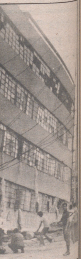
La foto, un edificio de cinco plantas, fue tomado entre los escombros tras el terremoto de Tailandia. (Telefoto Cifra Gráfica)
