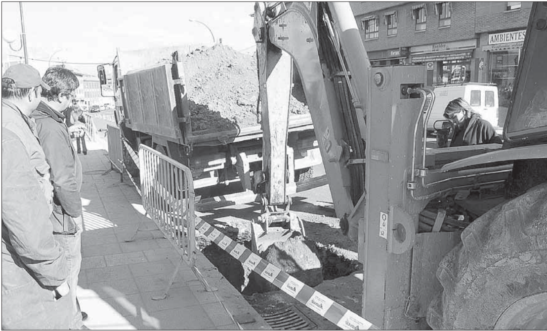
Los trabajos ocuparon finalmente la calzada de Vía Roma, provocando una alteración en la normal fluidez del tráfico por la avenida/KAMARERO
