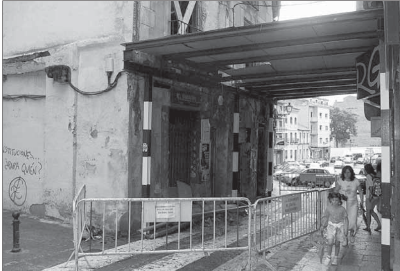
El estado del edificio ha obligado a adoptar medidas para garantizar la seguridad
