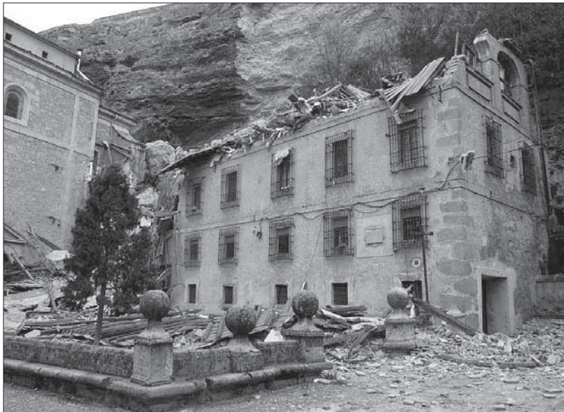
La Casa Rectoral quedó seriamente afectada tras el desplome de 2.000 toneladas de roca
