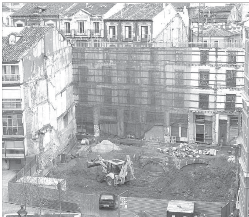
Una excavadora trabaja en las inmediaciones de la calle Platerías, en pleno centro de la capital vallisoletana. / EL DÍA
