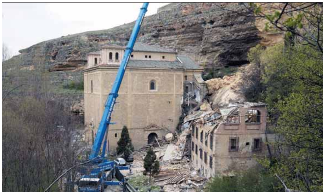
Los operarios revisaron la grieta detectada a través de una plataforma sujeta por la grúa de gran tonelaje
