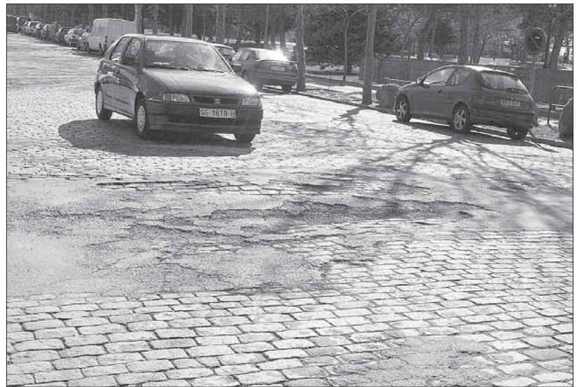
Numerosos baches se localizan en la avenida de la Constitución de Segovia
