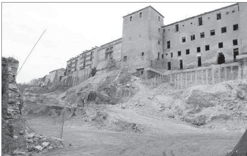
La propiedad restituirá la topografía del talud tras la construcción del parking
