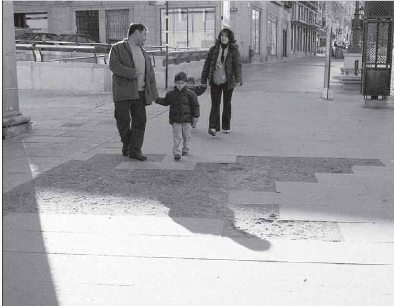
Las losas deterioradas se sitúan en el tramo de la avenida coincidente con el aparcamiento
