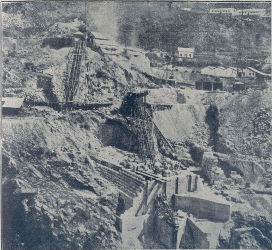
Obras del Pantano del Tranco de Beas - Empresa Constructora AGROMAN, S. A., Madrid
