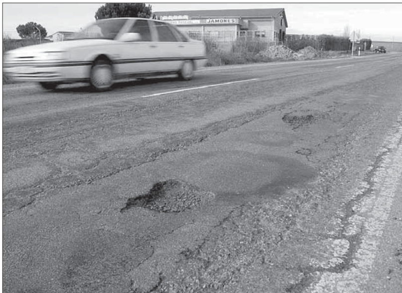
El mal estado del firme de la CL-601 ha sido objeto del inicio de algunas intervenciones
