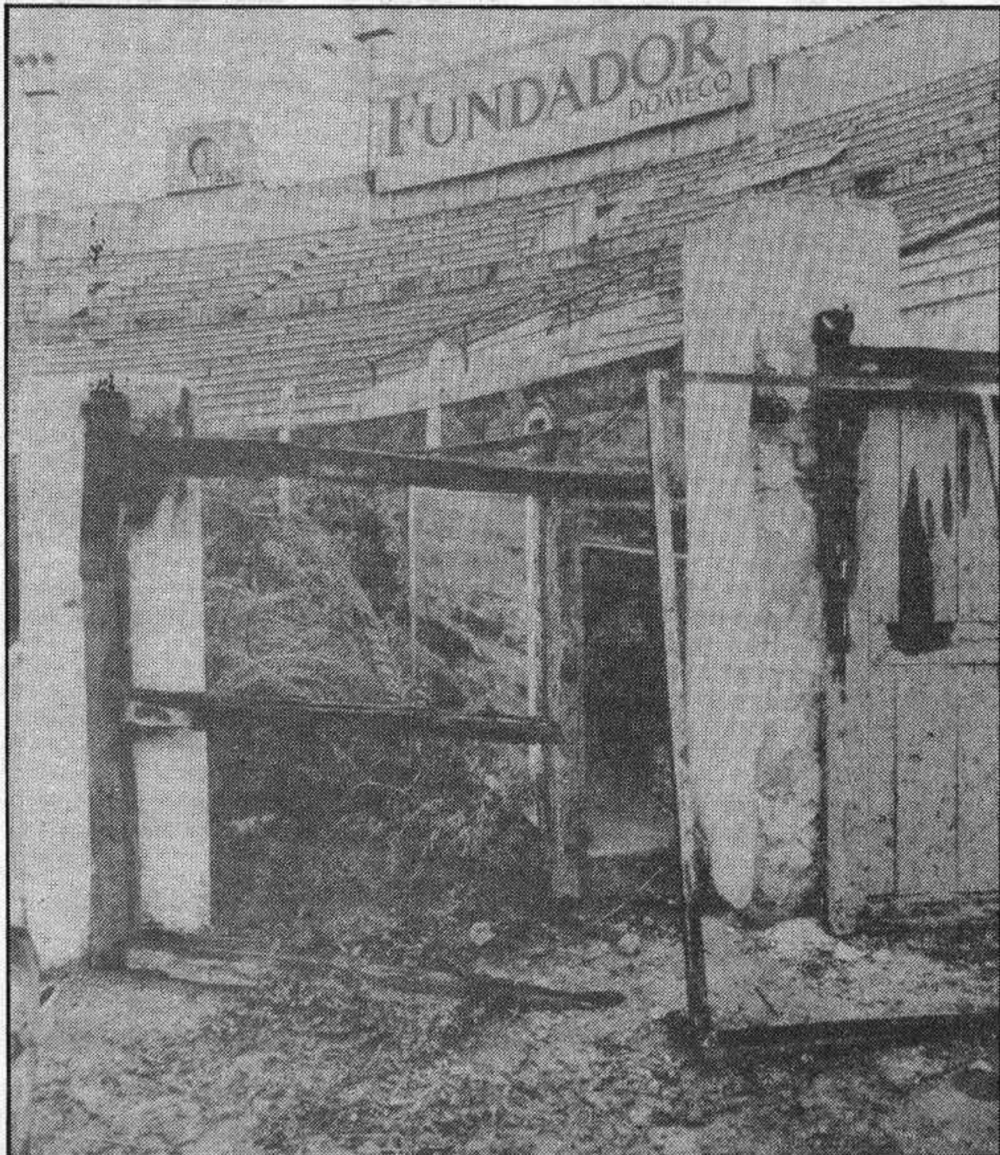
Hierba en el callejón y deterioro generalizado. Esta es la imagen que presenta en la actualidad.
