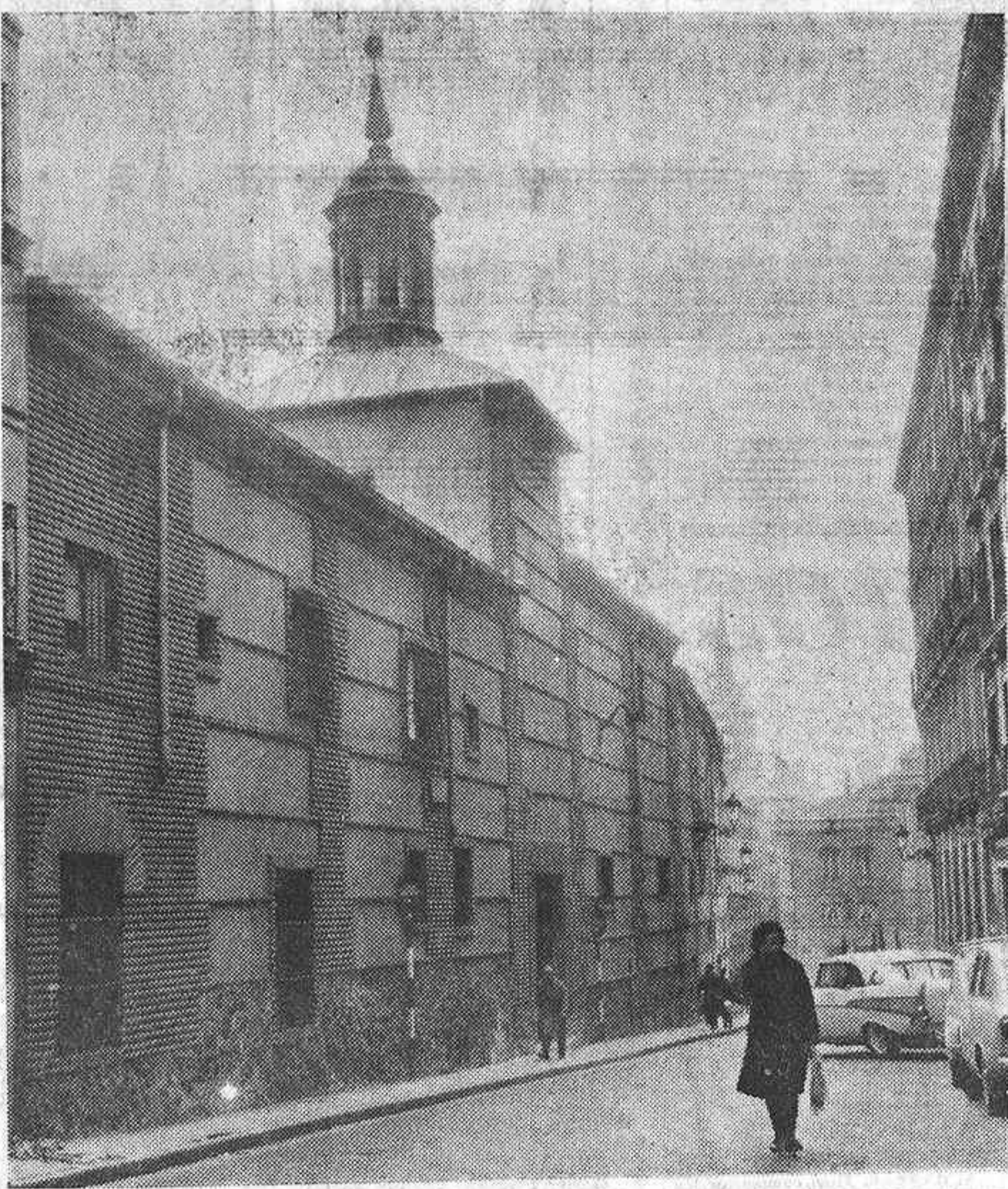
La parte donde se están construyendo en estos momentos las nuevas celdas individuales tiene acceso por el Postigo de San Martín y en un tiempo se hallaban las viviendas de demandados.
