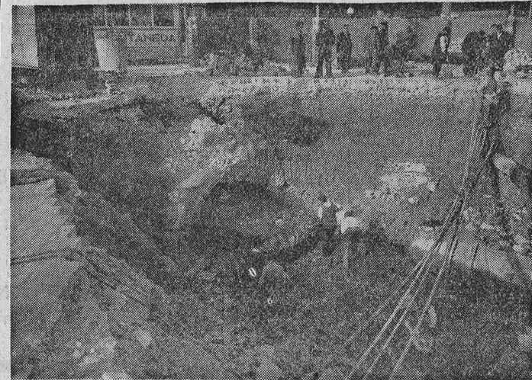
Cuando se produce algún hundimiento importante, como el que se ve en la fotografía, ocurrido en la glorieta de Atocha, aparece el subsuelo de Madrid lleno de ruinas, de galerías ciegas, de cables y de escombros
