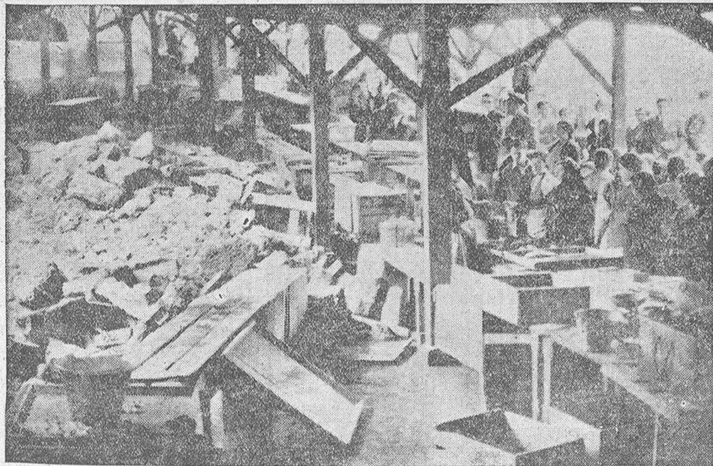
En este puesto del mercadillo de Santa Lucía fue donde el derrumbamiento del muro inmediato causó mayores daños y produjo gravísimas heridas a una mujer que allí se encontraba (Foto Blanco)
