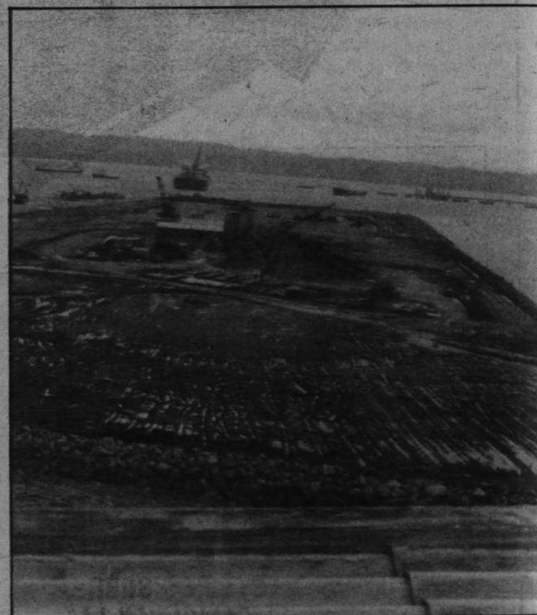
He aquí las obras del Muelle del Centenario de la Junta de Obras del Puerto, destinadas a convertir nuestras instalaciones en una de las mejores de España
