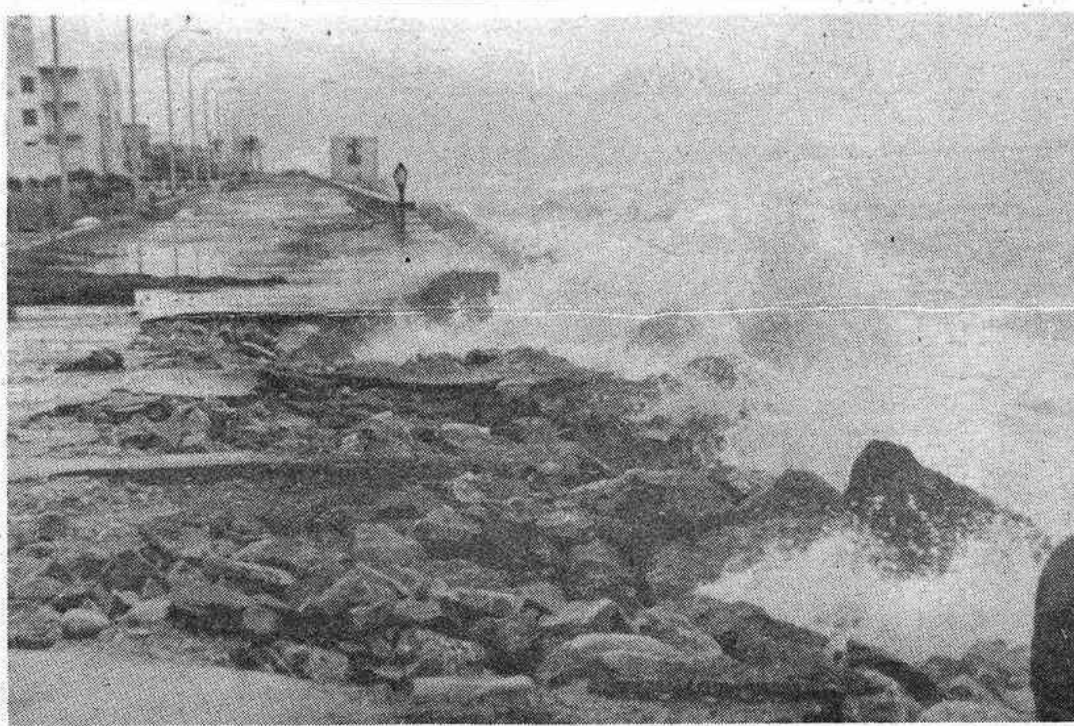
La fuerza de los temporales causaban daños de gravedad en Benafeli y Plá de la Torre cortando el camino de acceso por la costa
