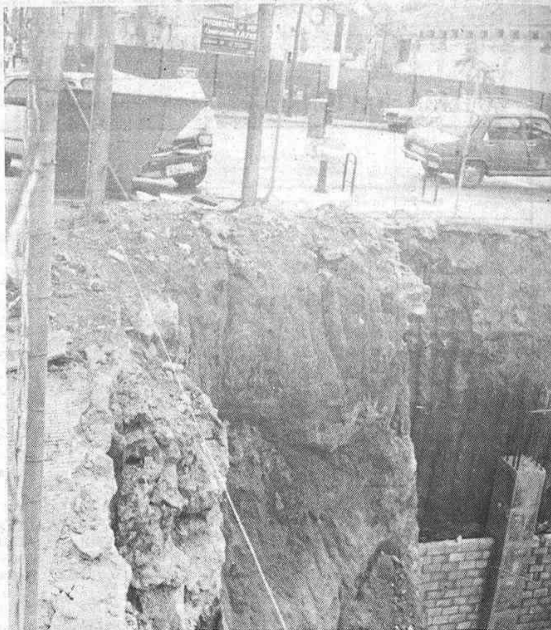
Al borde del gran socavón del edificio en construcción, quedó uno de los turismos implicados en el accidente de la avenida Hermanos Bou. (Foto Heredio)
