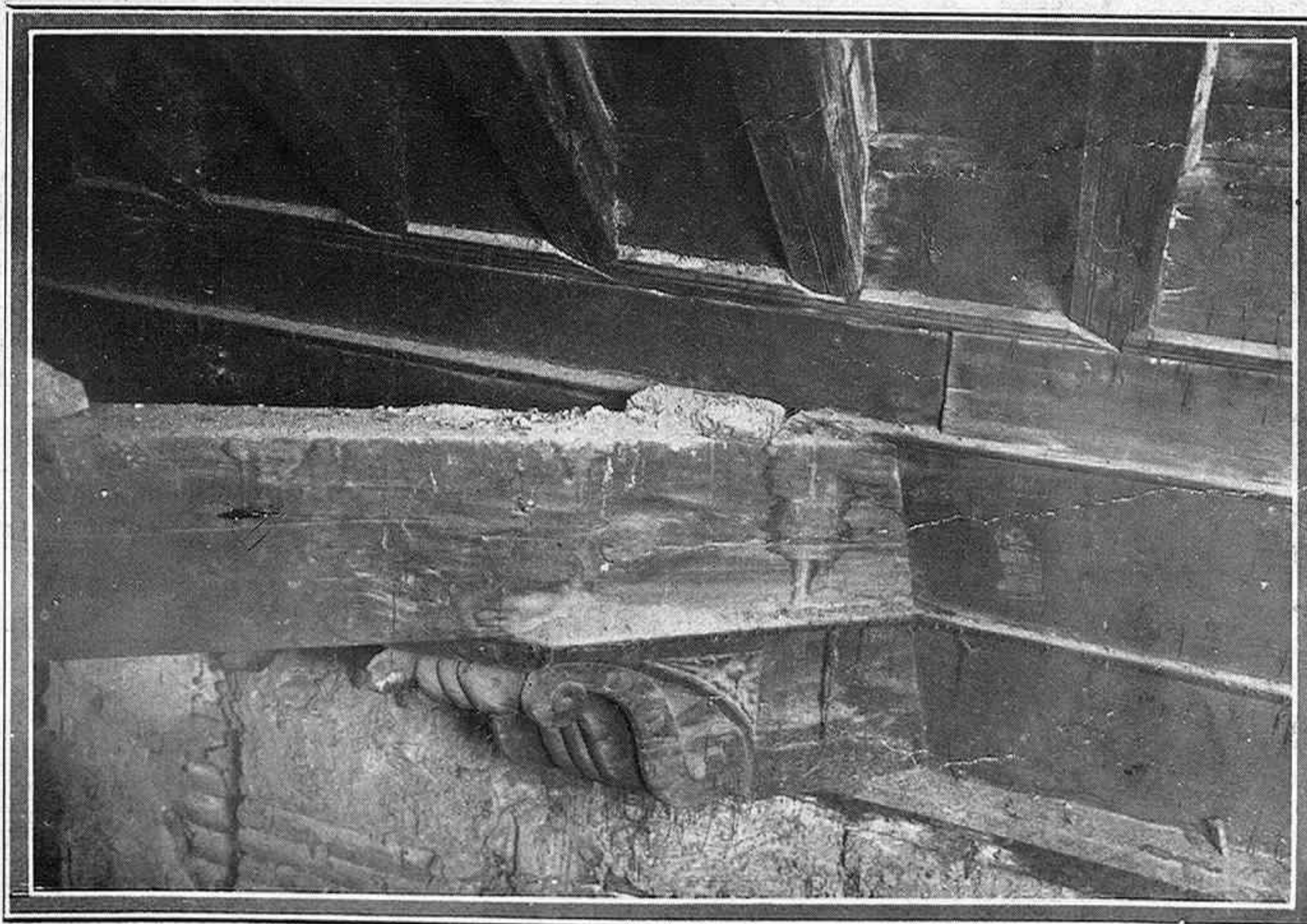
Un rincón del artesonado, zapata de viga tallada, de característica traza árabe (Fots. Cortés)
