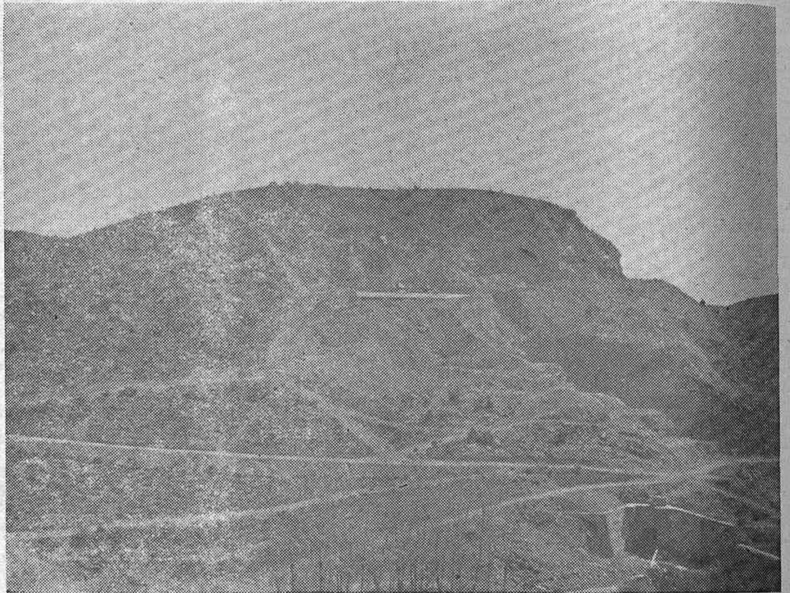
Así quedaron las obras iniciadas en el primitivo emplazamiento de la presa de Beleña. Significó una pérdida de 100 millones de pesetas. La lección parece que no ha sido suficiente cuando los problemas por la paralización de las obras en la nueva presa siguen siendo el pan nuestro de cada día.
