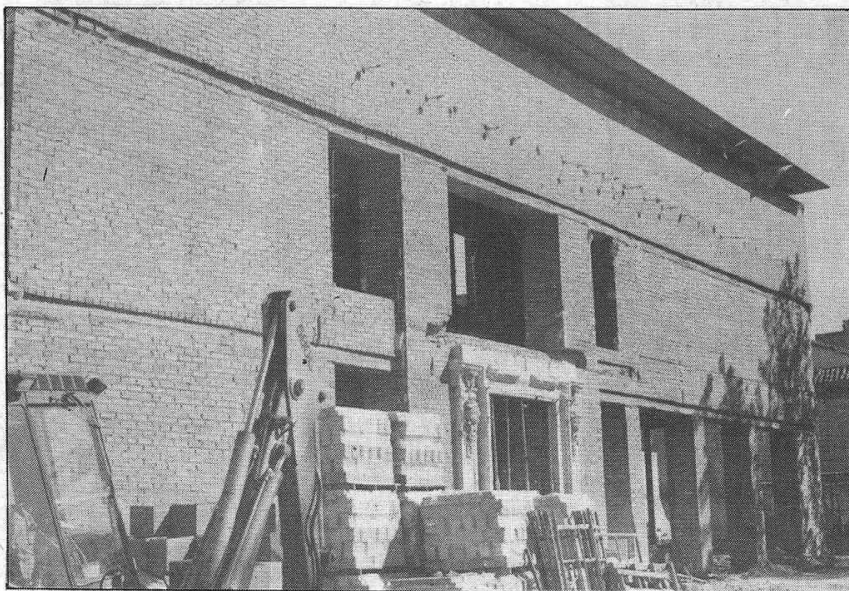
La Consejería tendrá que adjudicar de nuevo las obras de la Residencia de Estudiantes, actualmente paralizadas por quiebra de la empresa constructora ALVARO NUÑO
