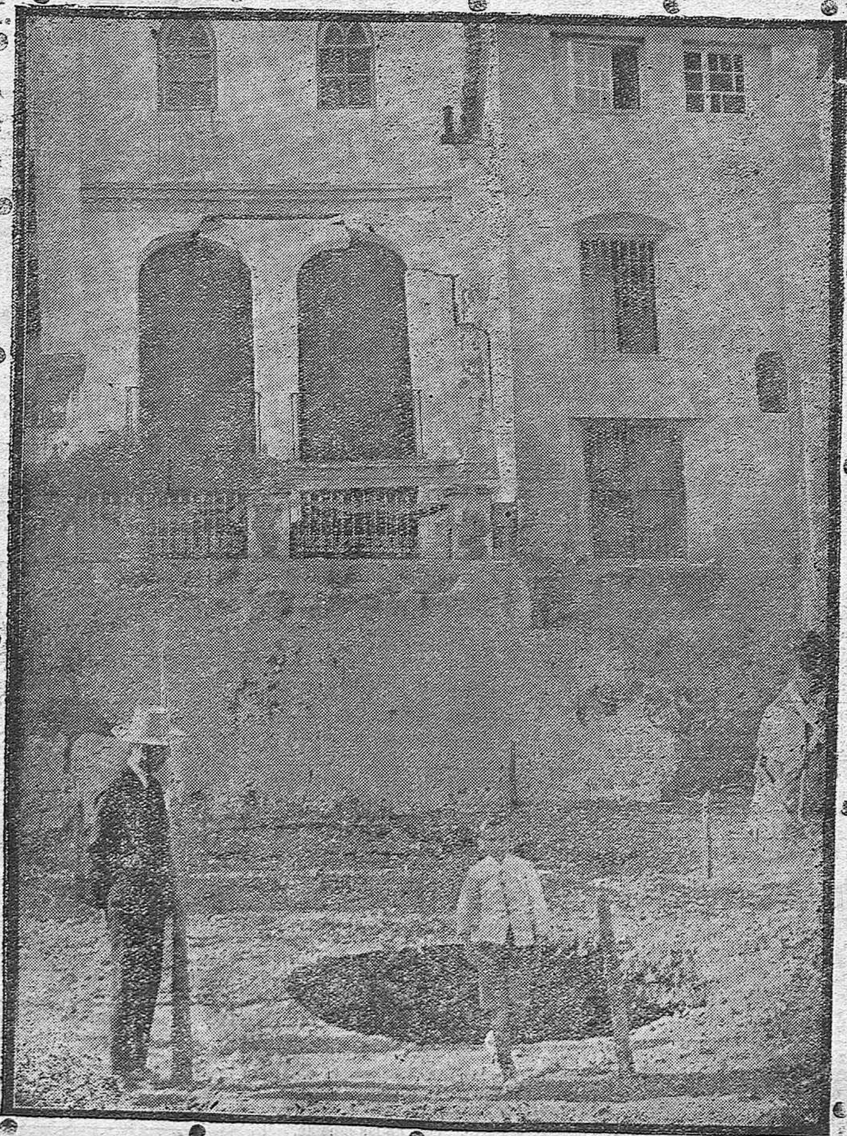
Estado en que ha quedado el despacho rectoral del Seminario de San Pelagio, y hundimientos que se han presentado en el exterior del edificio que mira hacia el río.
