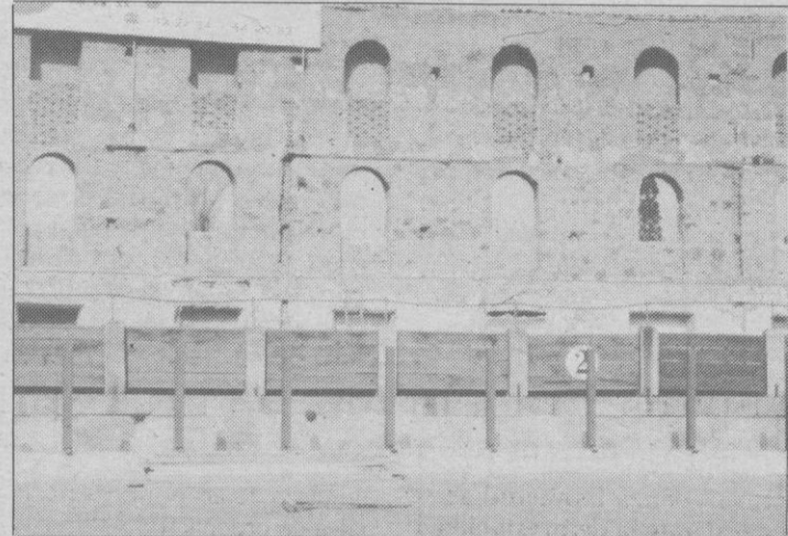
Los tendidos 1 y 2 derruidos totalmente.
