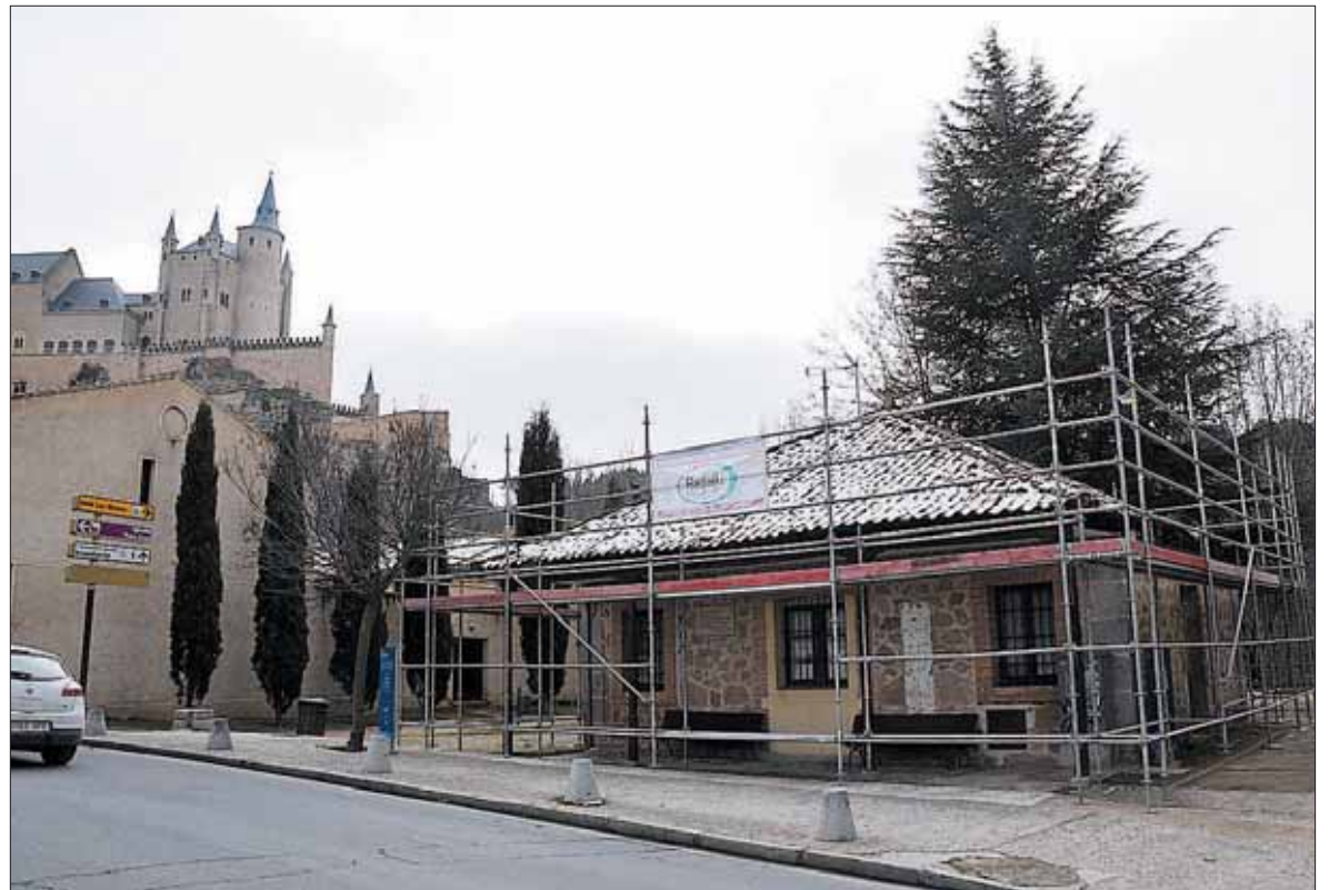
El Ayuntamiento ha procedido a instalar andamios para acceder a la cubierta del fielato. / JUAN MARTÍN
