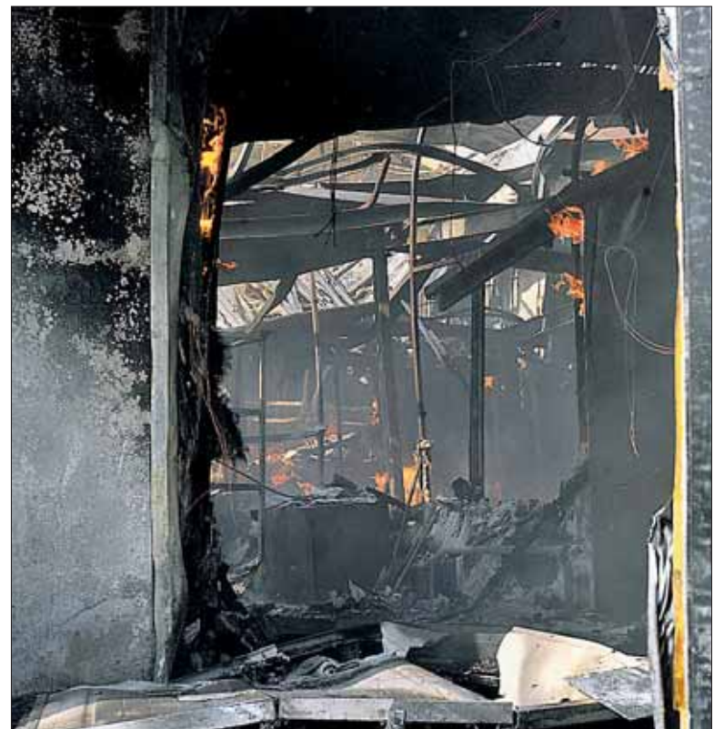
El interior de la jamonera quedó totalmente calcinado. / KAMARERO
