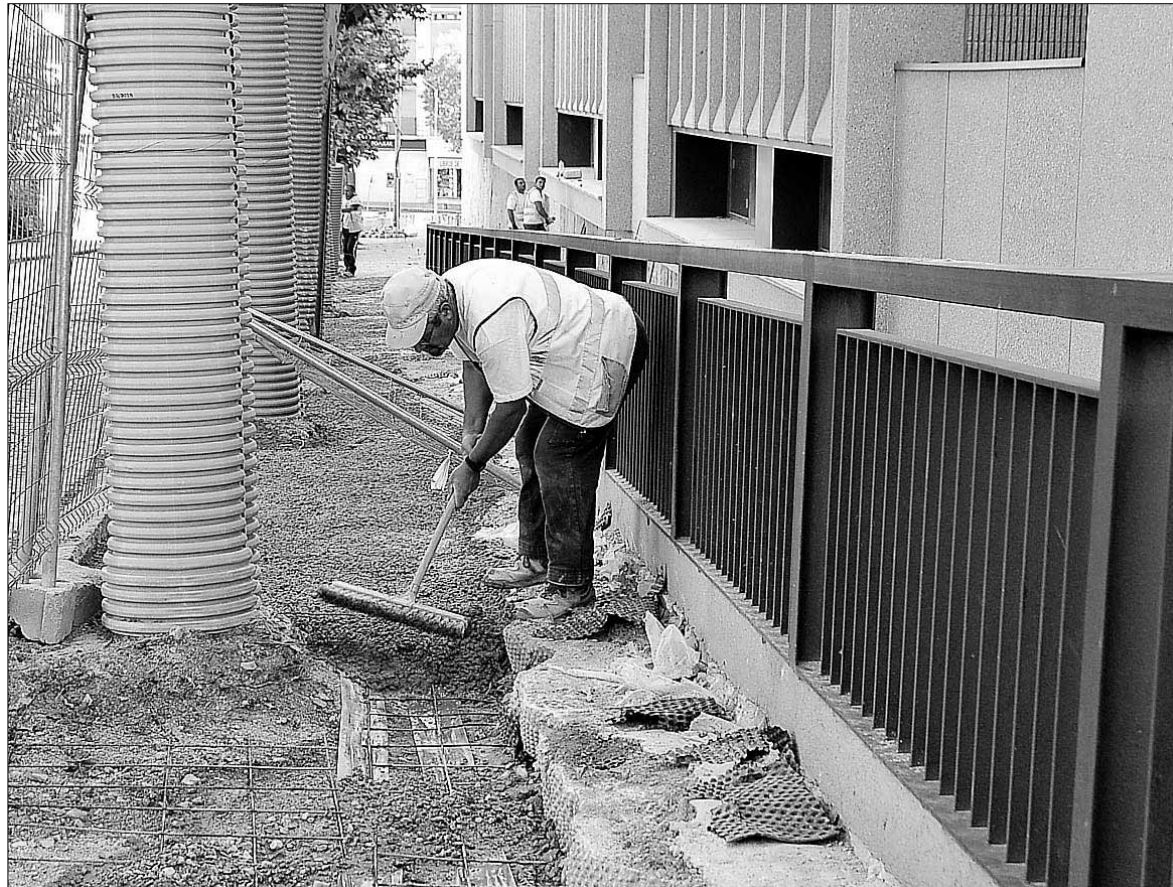
Los trabajadores de la empresa Opyser reforman las aceras de la calle Coronel Rexach. / ALBERTO BENAVENTE
