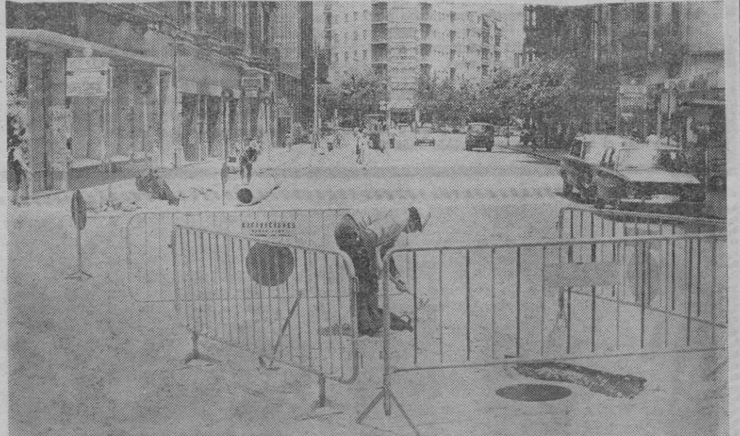
Tramo San Antonio-Avenidas, calle de Sindicato, zanjas y canalizaciones en marcha. Centrando la foto, comienzo de excavaciones.
