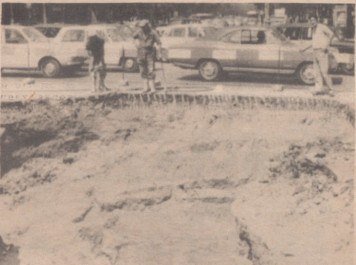
BARCELONA.— El martes por la noche se produjo un socavón en las inmediaciones de las obras del metro de la Avda. de José Antonio-Paseo de Gracia, que mide unos 4 metros de profundidad. Un seiscientos cayó en él, con dos ocupantes, los cuales tuvieron que ser ayudados por los bomberos para salir, resultando afortunadamente con heridas leves. —(Foto Cifra Gráfica).
