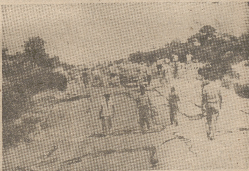
EL TERREMOTO EN LA AUTOPISTA Así quedó esta carretera de Méjico, en las proximidades de la ciudad de Jaltipán, a consecuencia del violento terremoto registrado el pasado 26 de agosto, que provocó el derrumbamiento de 200 casas en el Estado de Veracruz. (Foto Cifra.)
