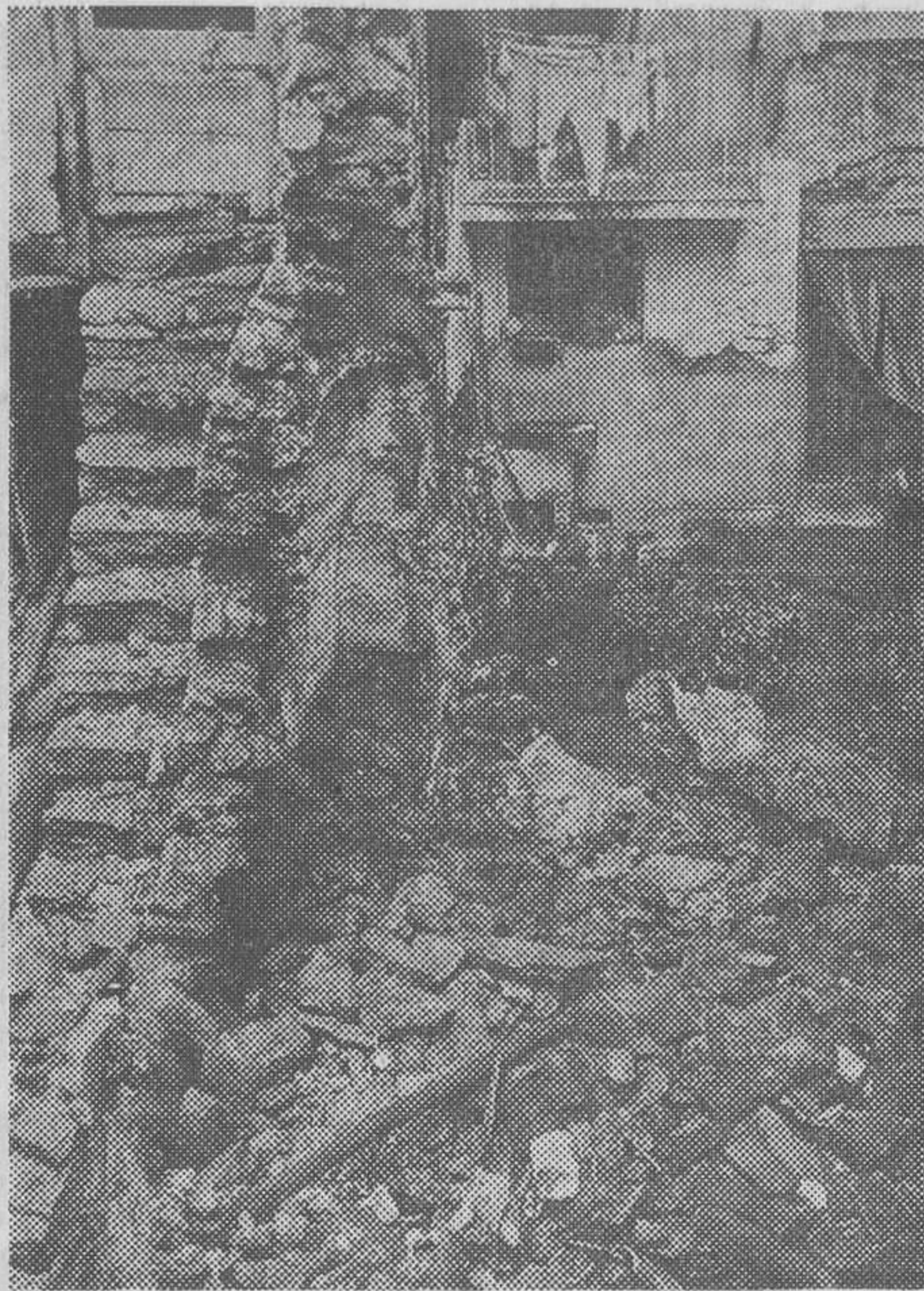
Las piedras de una casa derrumbada en Sort cayeron al patio la contigua, aún habitada (Foto R. Font)
