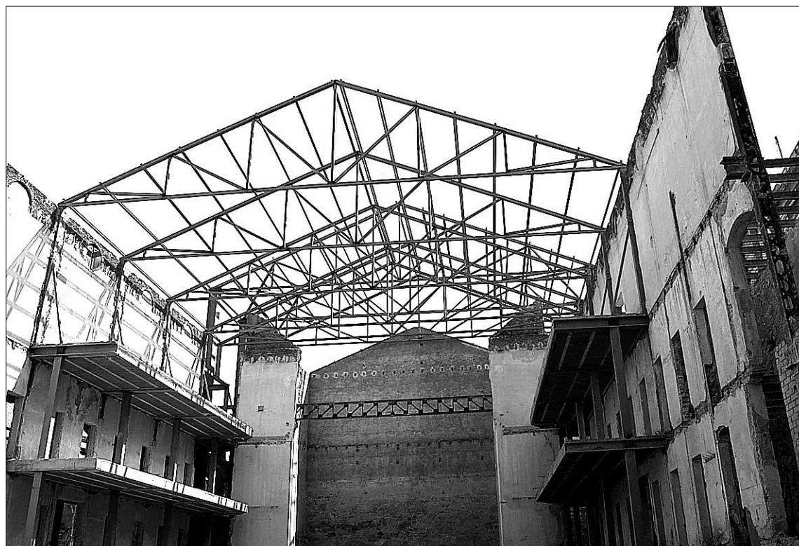
Las cerchas colocadas en el Cervantes deben ser retiradas al exceder su altura a la autorizada en el proyecto por la Junta/J.M.
